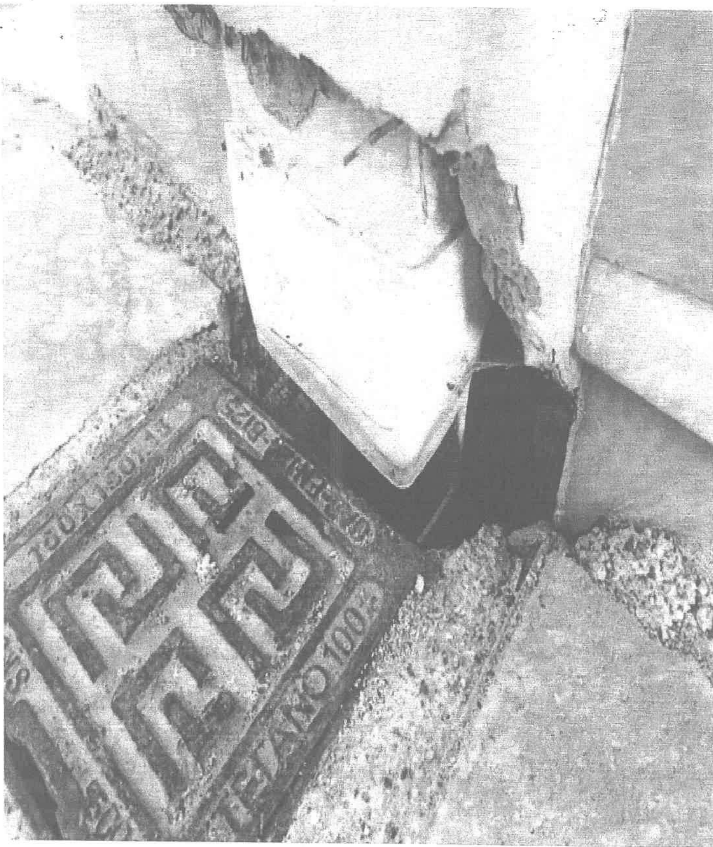
ΦΩΤΟ 5 : ΚΑΤΑΣΚΕΥΑΣΤΙΚΗ ΑΤΕΛΕΙΑ ΜΕ ΣΥΝΔΕΣΗ ΚΑΘΕΤΗΣ ΚΑΙ ΟΡΙΖΟΝΤΙΑΣ ΥΔΡΟΡΟΗΣ ΧΩΡΙΣ ΓΩΝΙΑ (ΑΣΤΟΚΑΡΙΣΤΟΣ ΧΩΡΟΣ ΠΙΣΩ ΑΠΟ ΤΗΝ ΥΔΡΟΡΟΗ ΜΕ ΟΜΒΡΙΑ ΣΕ ΕΠΑΦΗ ΜΕ ΤΟ ΤΟΙΧΕΙΟ ΤΗΣ ΙΔΙΟΚΤΗΣΙΑΣ ΣΕ ΟΛΟΚΛΗΡΩΜΕΝΟ ΤΜΗΜΑ ΤΗΣ ΕΡΓΟΛΑΒΙΑΣ)
